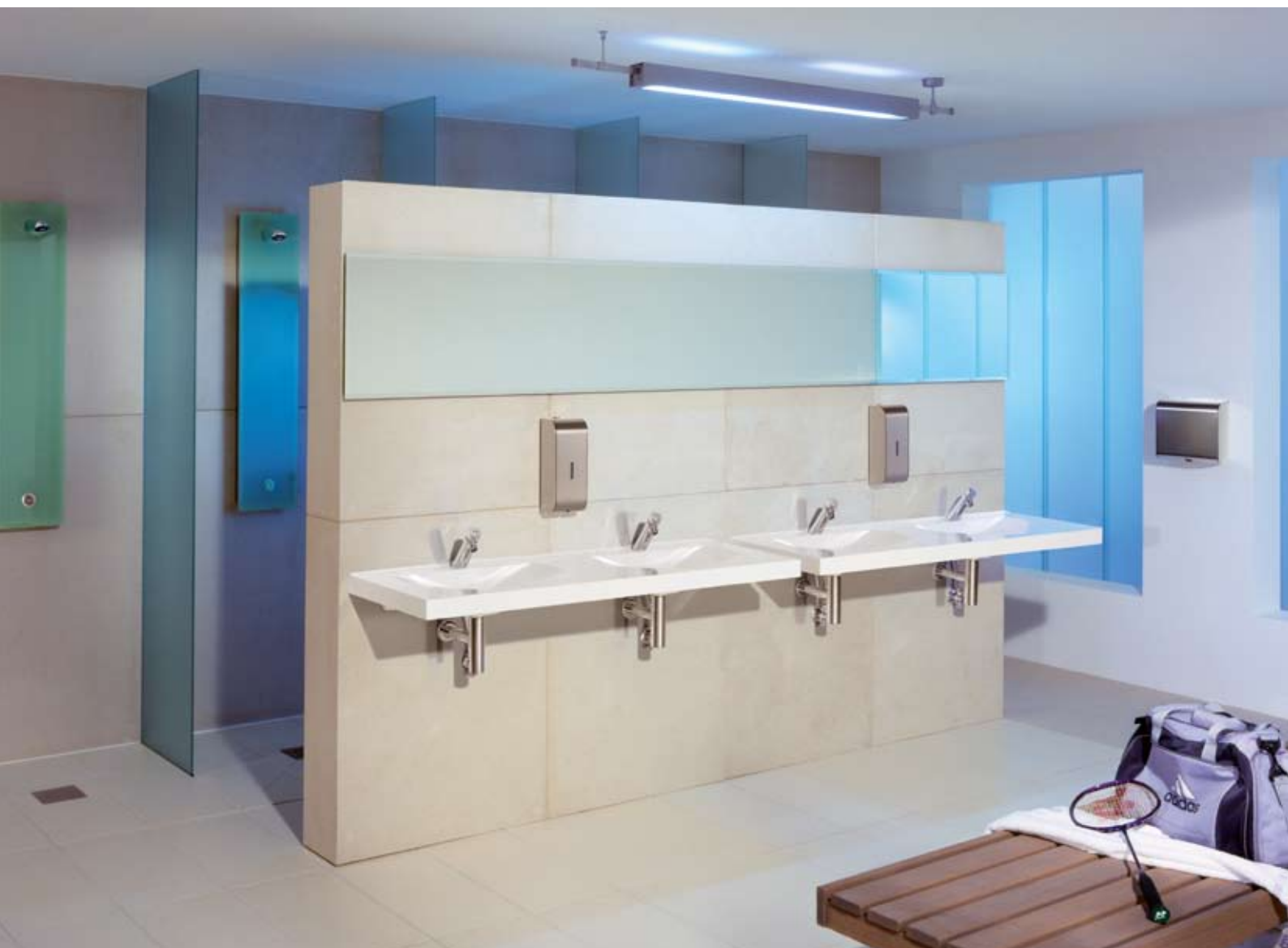
Športové sociálne zariadenie s dvojkombináciou dvoch umývadiel RONDA so stojankovými tlačnými ventilmi AQUAMIX-S a doplnkami série XINOX®.
